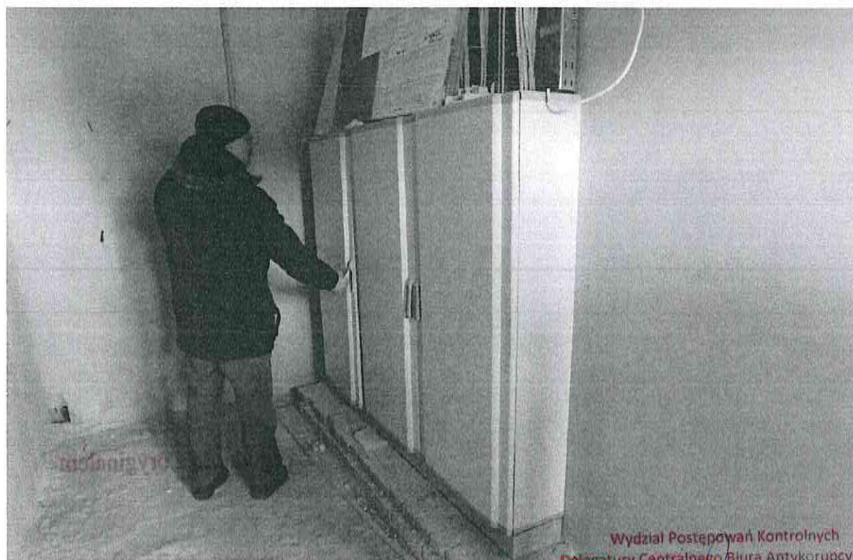
Fot.68. Rozdzielnia główna budynku
