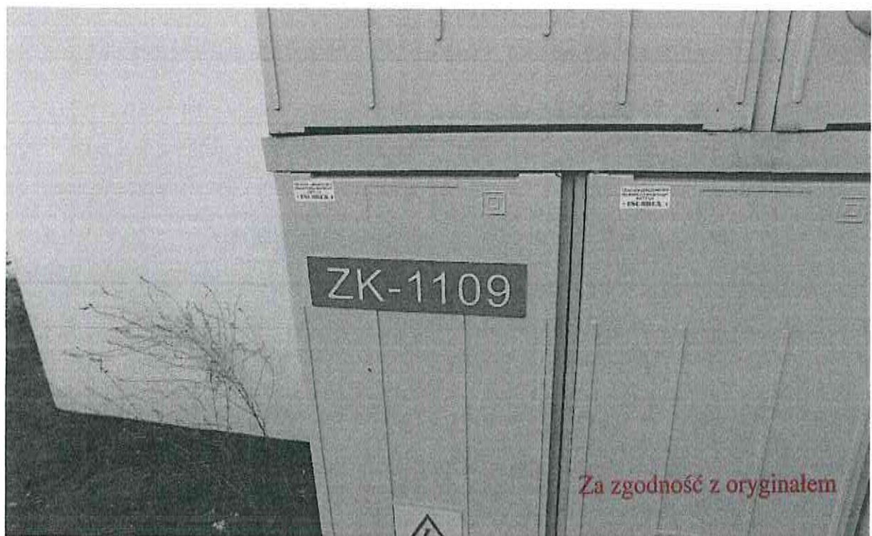
Fot.74. Złącze kablowo pomiarowe budynku
