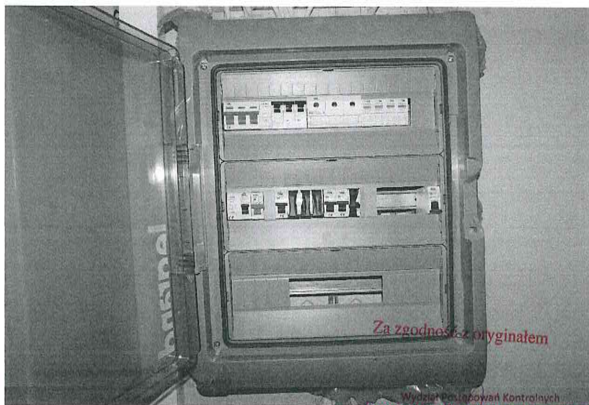
Fot.50. Tablica elektryczna piętro
