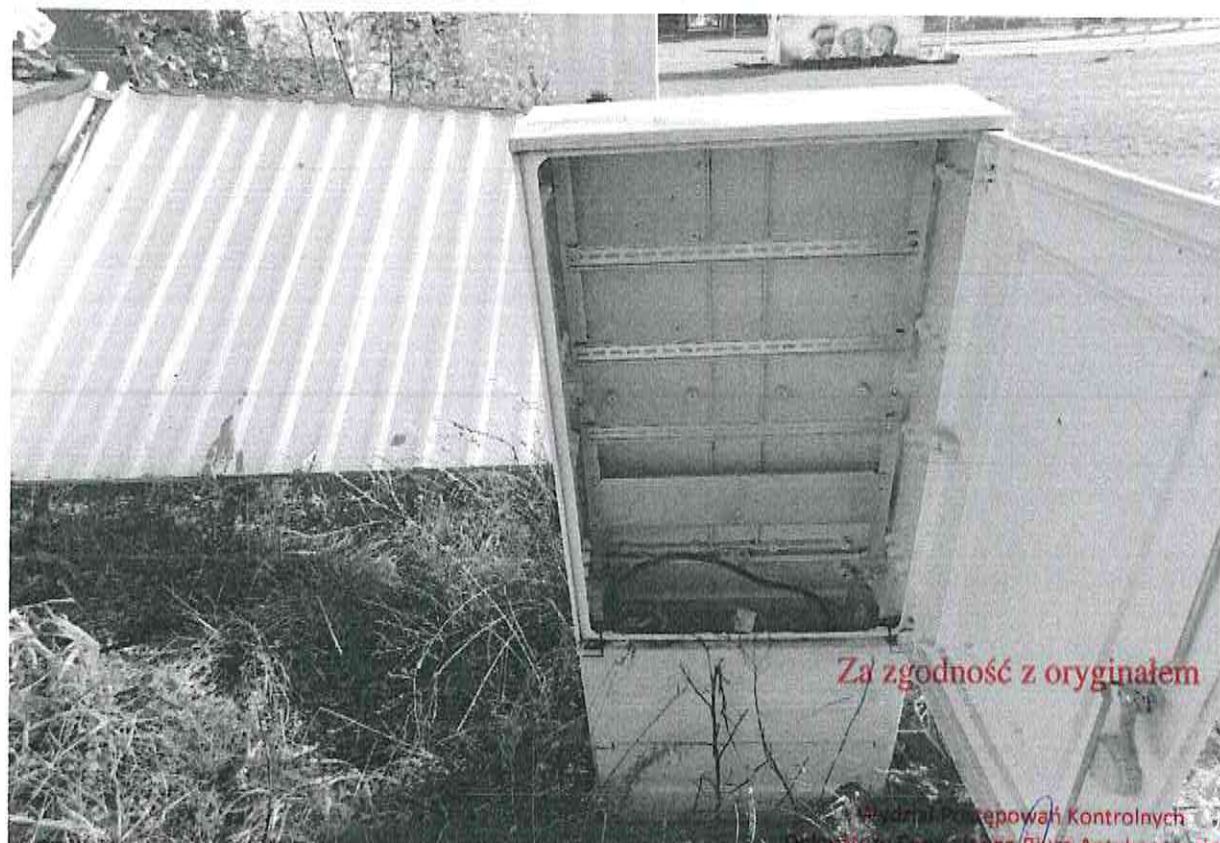
Fot.66. Skrzynka elektryczna nie uzbrojona
