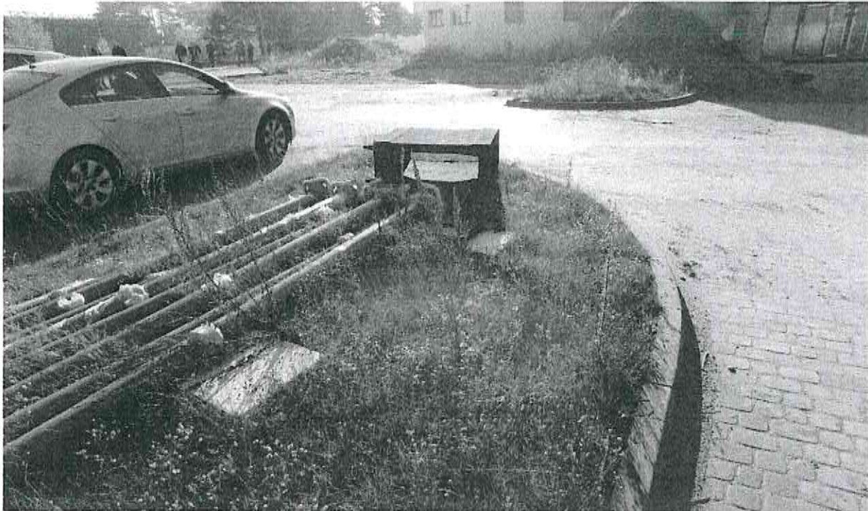
Fot.75. Niezamontowane słupy oraz fundamenty
