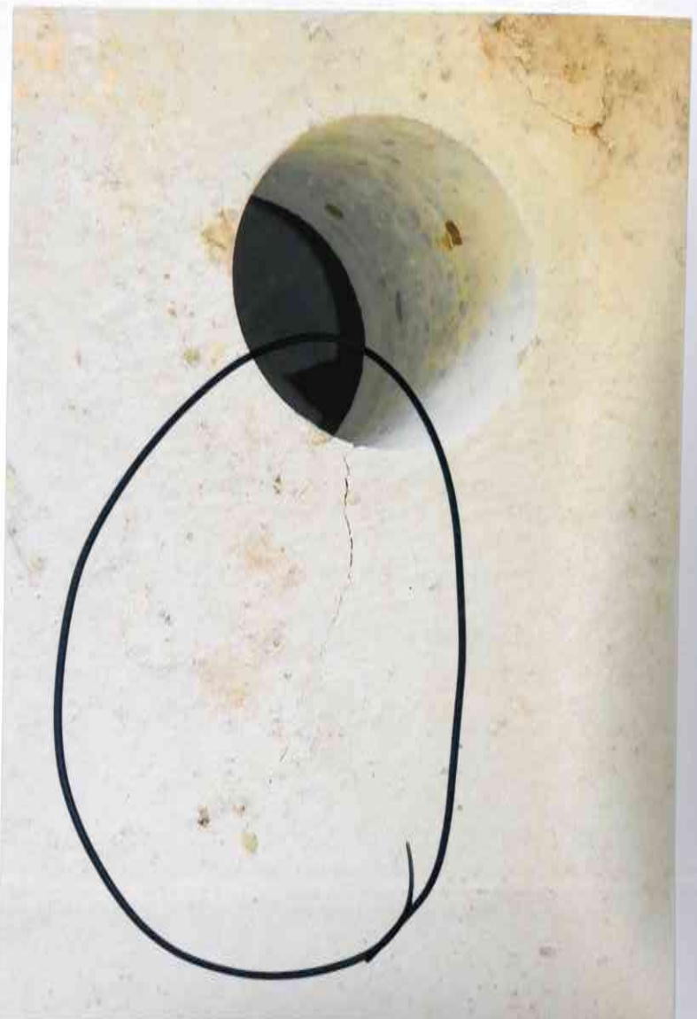
Zbliżenie długo liniowych pęknięć stropu żelbetowego.
