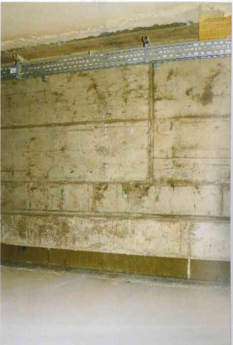
zbliżenie niskiej jakości deskowania pod strop żelbetowy.
