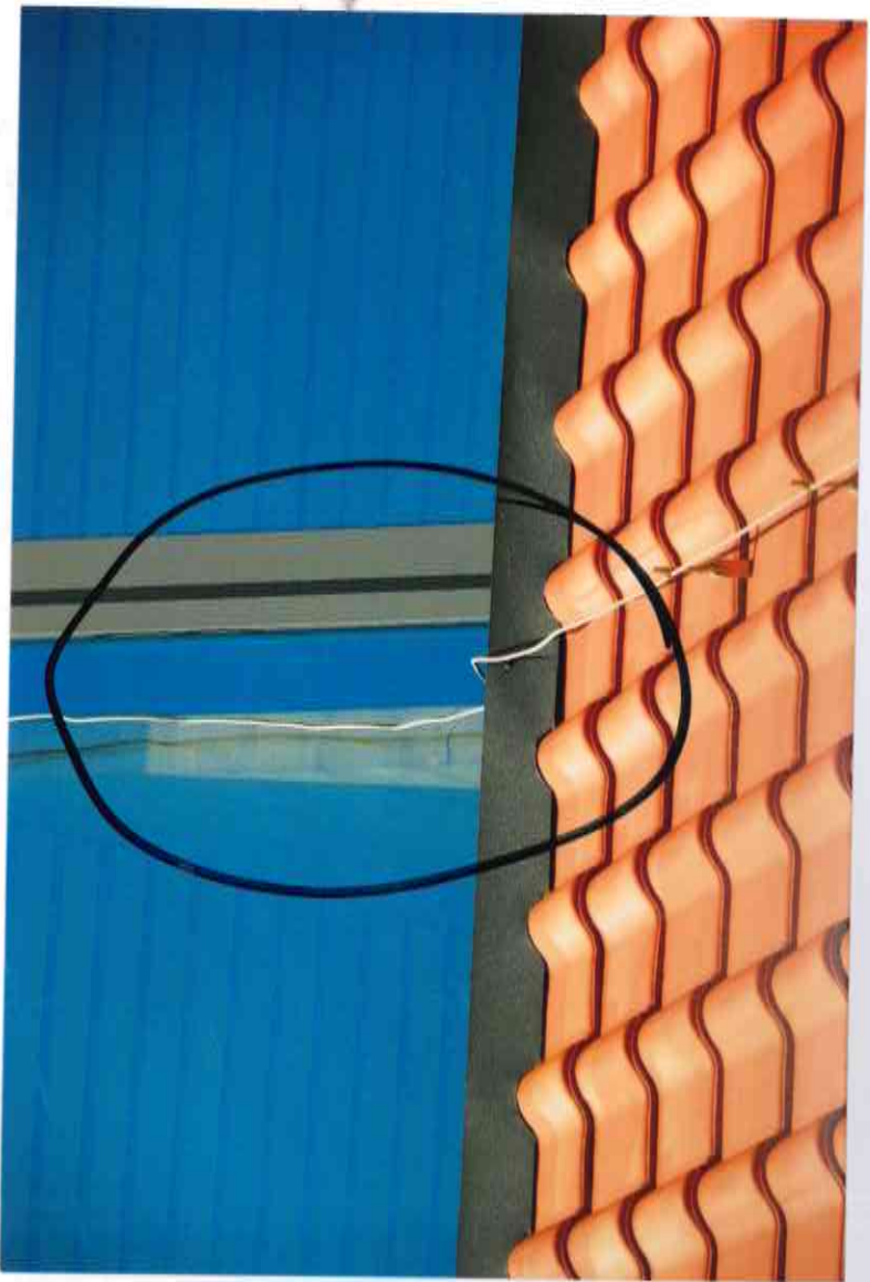
Luźno ułożona instalacja odgromowa.
